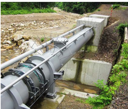
写真2 一か所だけ地表面に現れた導水管 (ここ以外は基本的に道路下に埋設、同時に同社が道路整備を自社負担で行った)
