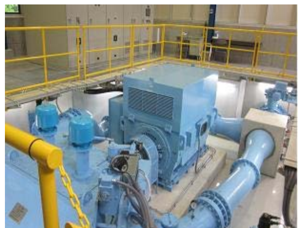
写真3 発電所内部の水車と発電機 (手前がターボ式水車、向う側が発電機)
