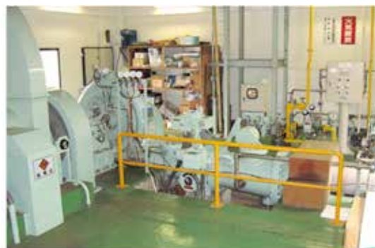
西目土地改良区の発電所内部
