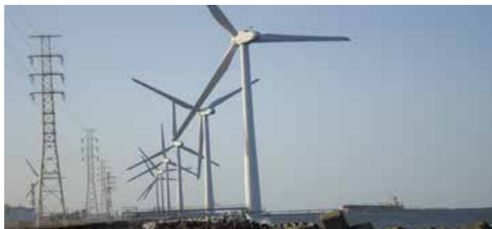
鹿島コンビナートの防波堤 20～30m沖の洋上風力発電機
