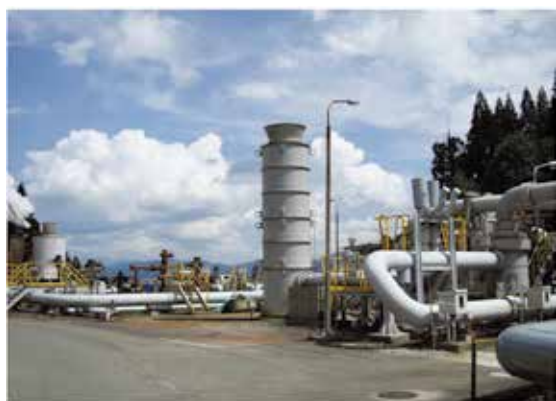
東北水力地熱(株)の地熱蒸気採取施設
