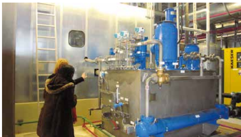
熱供給施設内
