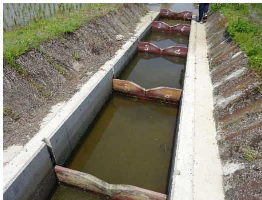
排水路に設置された魚道
