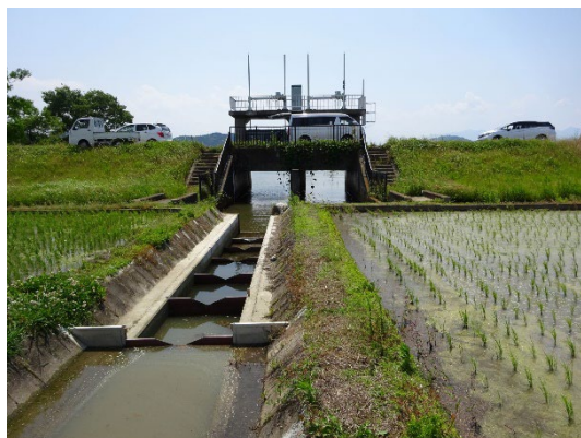
琵琶湖の水門と排水路に設置された魚道
