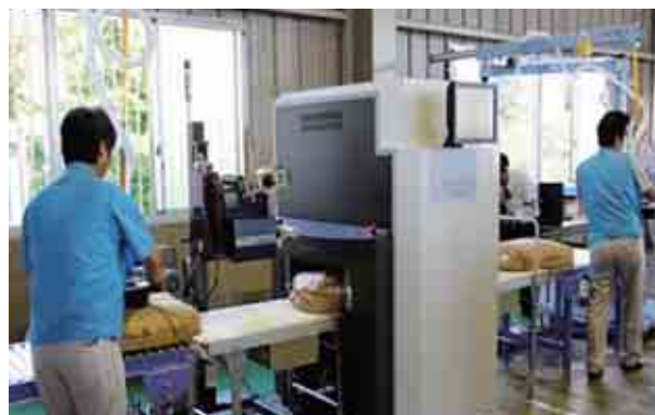
全袋検査をする放射能測定装置 (JAみちのく安達での装置設置・検収作業)
