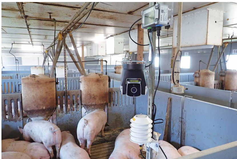
豚舎内に設置したカメラ、温湿度センサー、無線送信機(写真：NTT東日本提供)
